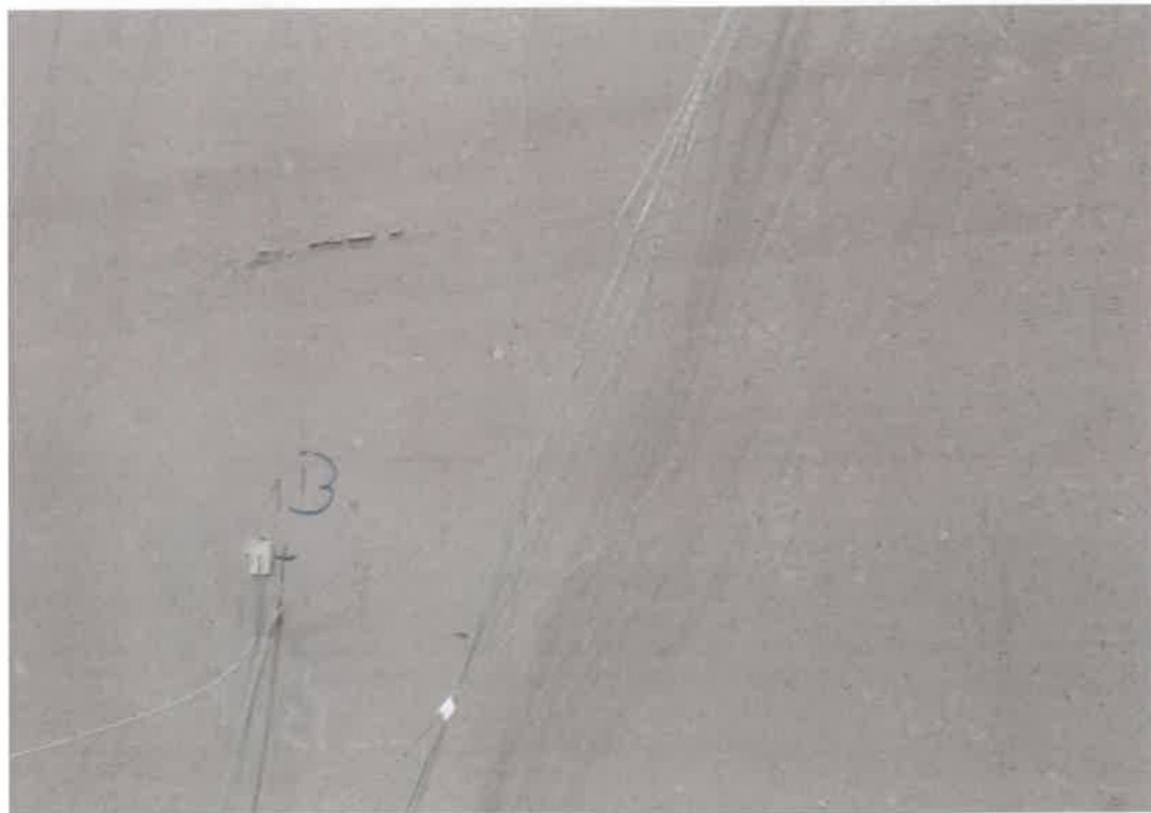
7. Minute: Vertikaler Haarriss mittig zwischen den Messstellen 1 und 3 (FA).
