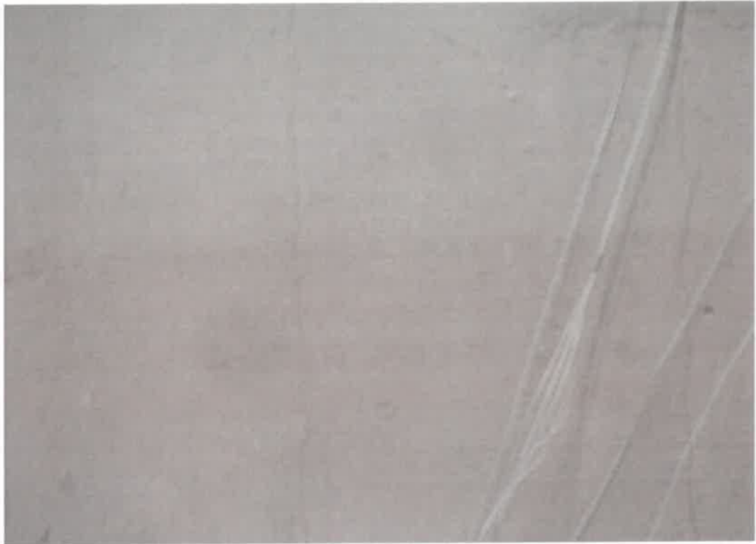
3. Minute: Weiterer vertikale Riss zwischen den Messstellen 3 und 5 (FA).
