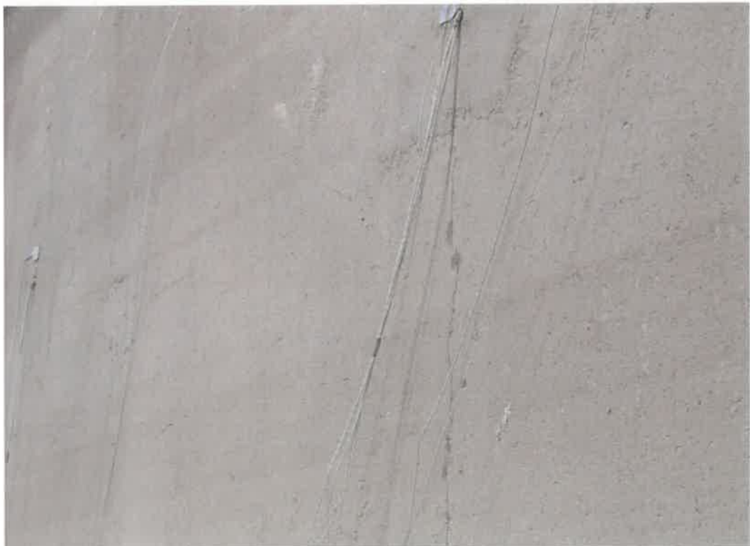
50. Minute: Kondeswasseraustritt an Riss bei Messstelle 3 (FA).
