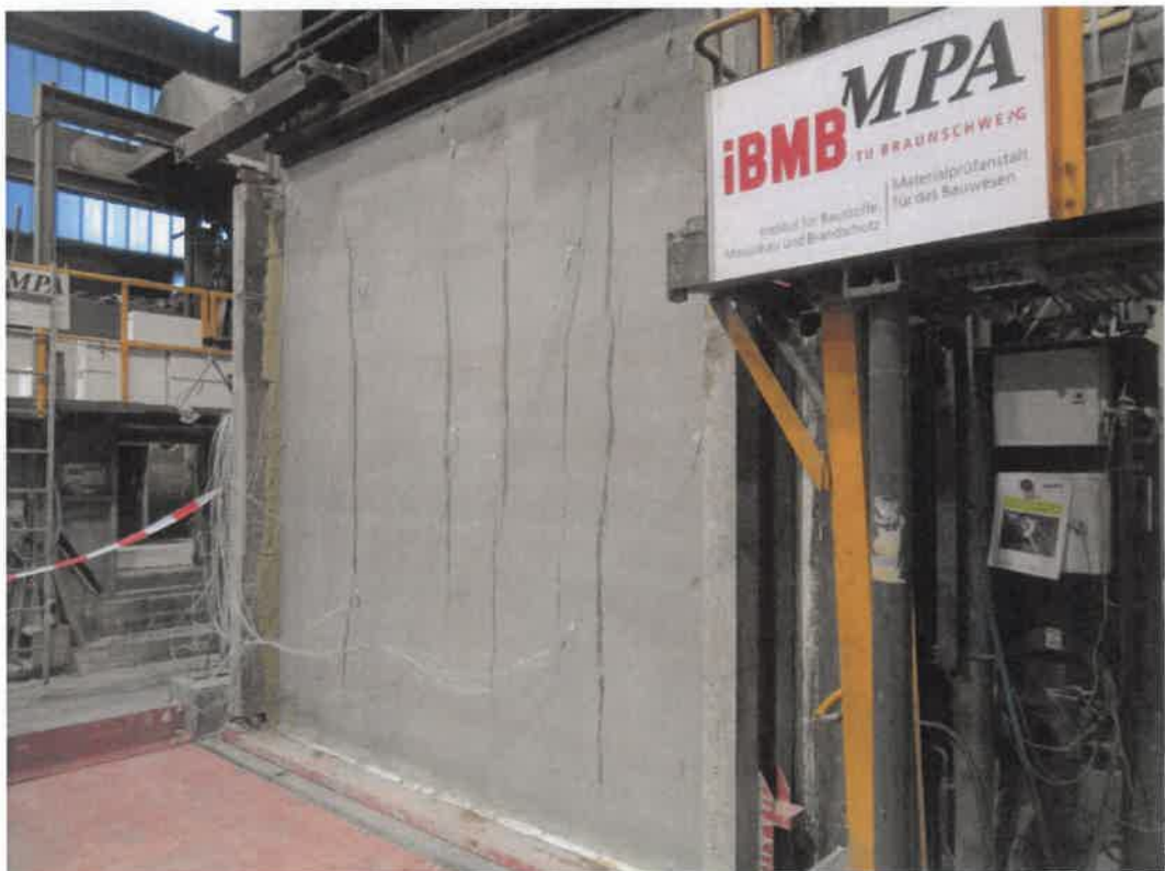
180. Minute: Weiteres Kondenswasser tritt an den Rissen aus (FA).
