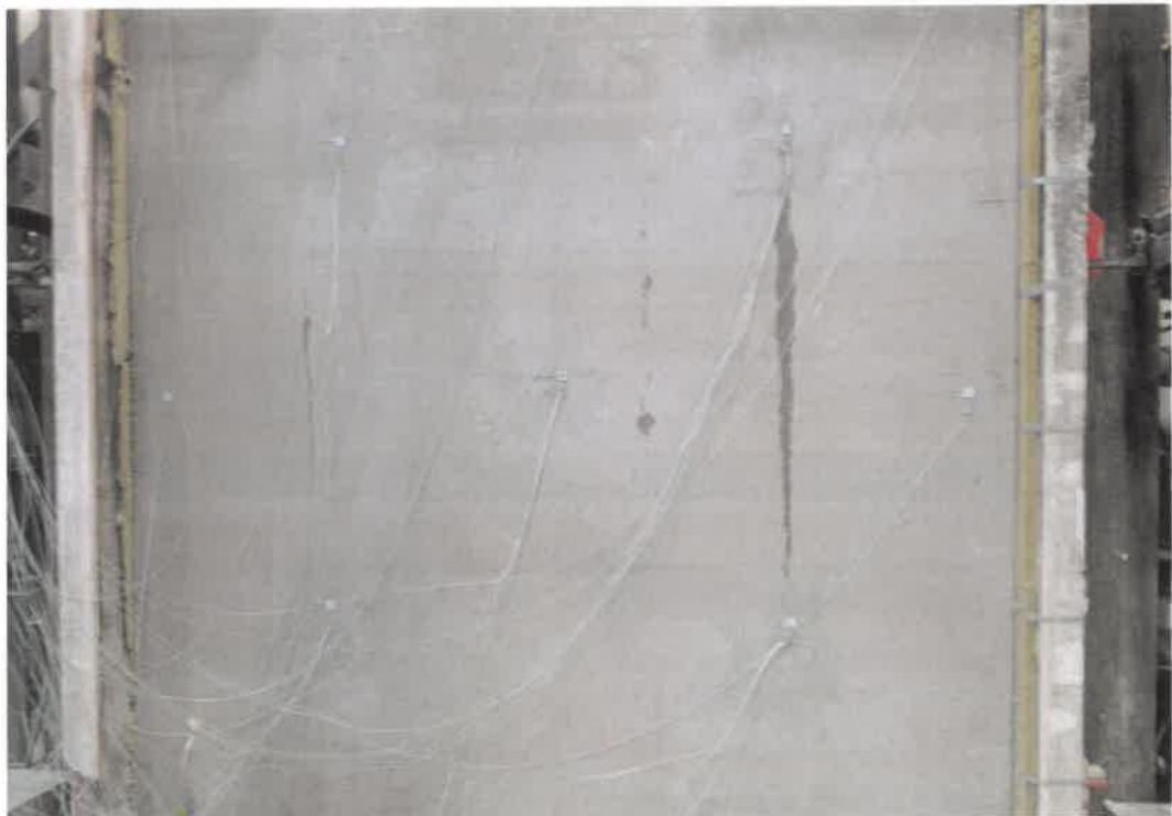
67. Minute: Kondenswasseraustritt an allen Rissen sichtbar (FA).
